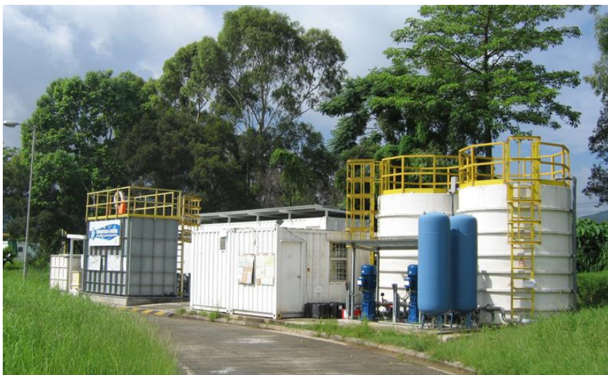
圖 3.8 石湖墟污水處理廠再造水處理裝置
